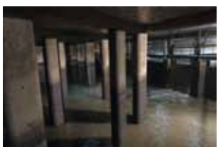
SUASIART Túneles en zona de calderas, La Laboral, Gijón
